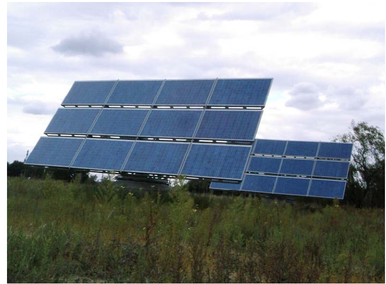
Fotovoltaikanlage in Berlin-Adlershof Quelle: Wikipedia
